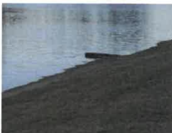
Exposed Pipe - No MES (2018)
